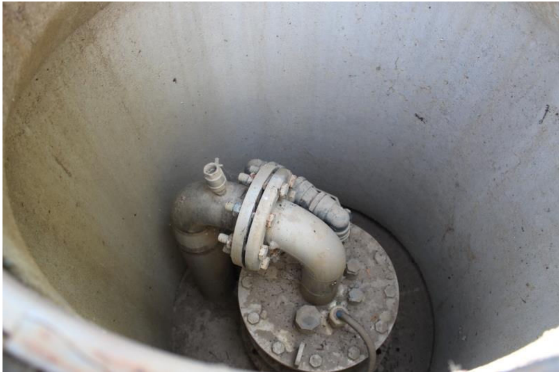
Tête étanche du forage F1 avec son alimentation électrique, à l'intérieur du cuvelage en béton.
